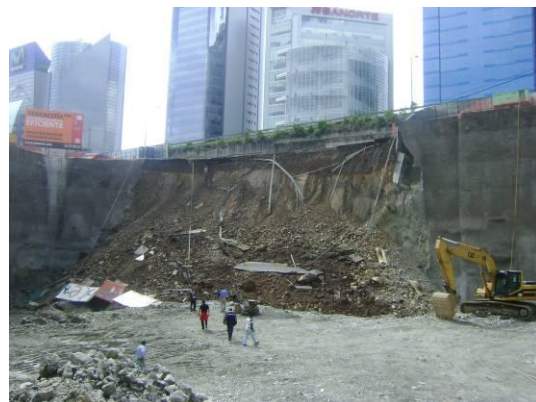
Fig 1.2, Vistas exterior e interior del deslizamiento
