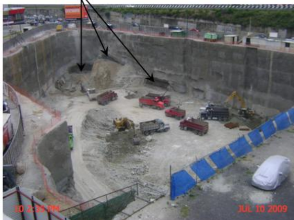
Figura 3.3 Vistas de las irregularidades y bolsas de caídos al pie de la excavación previas al deslizamiento general
