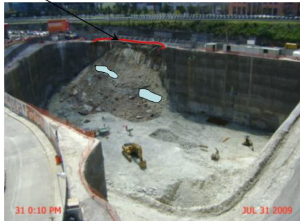
Figura 3.4 Sobreposición de las bolsas o caídos previos sobre el deslizamiento general
