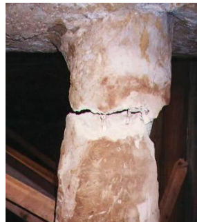
Figura 10. Discontinuidad de la sección de la pila.
