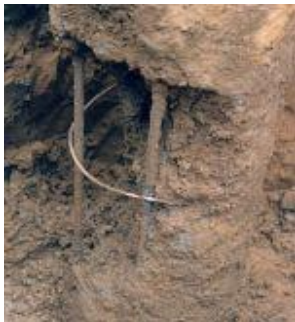
Figura 9. Contaminación del concreto de la pila
