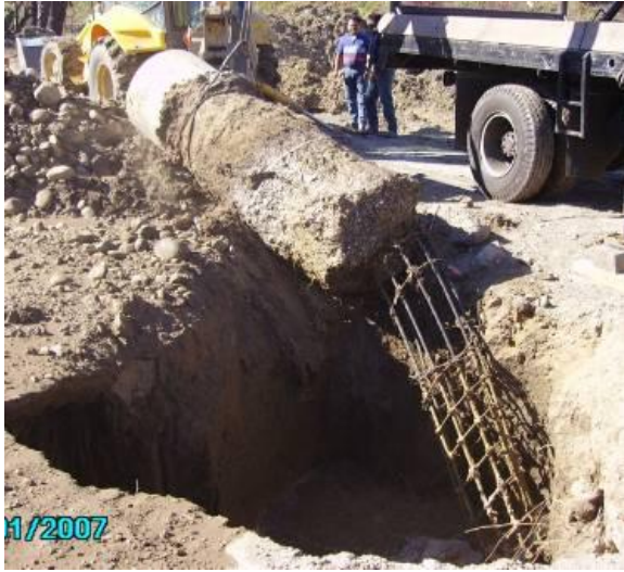
Fig. 12, Extracción de la pila ensayada. Obsérvese la ausencia de concreto a los 1.5m de profundidad.
