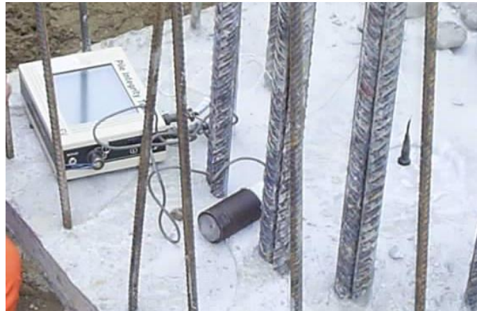
Figura 1 Equipo de la prueba de integridad
